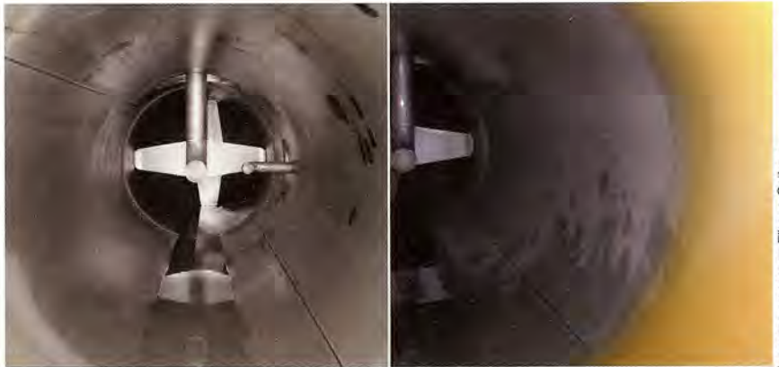
Abb. 8: Neue Kalkdosierung; links: 2. Baustufe kurz nach dem Einbau, rechts: 1. Baustufe (parallele Reinwasserleitung) bei Begehung am 9. Februar 2010
