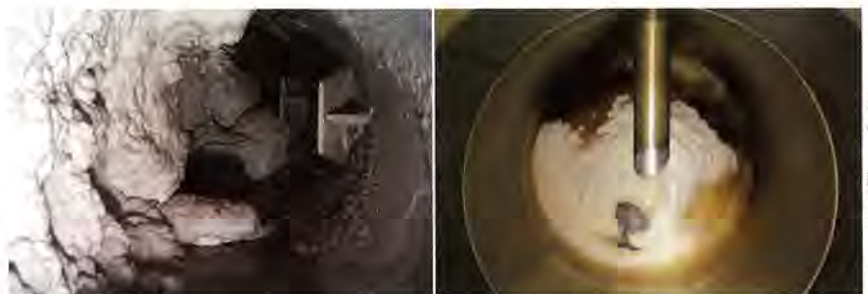
Abb. 2: Kalksteinbildung im Reinwasserrohr; links: Blick entgegen der Fließrichtung auf den statischen Mischer, rechts: Blick in Fließrichtung auf die Dosierlanze zur \text{CO}_2 -Zugabe
