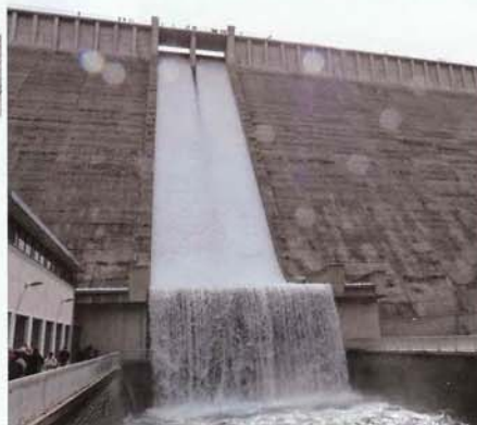
Überfallströmung an der Talsperre Leibis-Lichte zum Probestau im April 2010 Foto: Aigner
